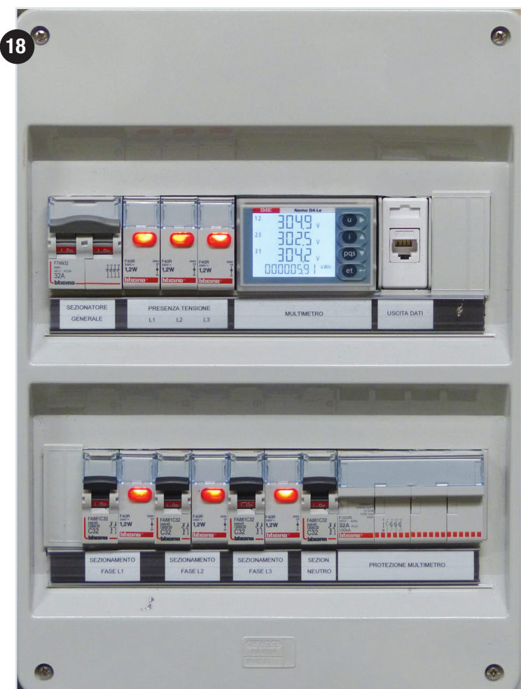
18 / Le boîtier conçu par Powersoft pour tester et démontrer la capacité de l'ampli à encaisser les changements les plus originaux dans son alimentation ; monophasé, triphasé, perte du neutre ... sans aucun clic dans l'audio.
